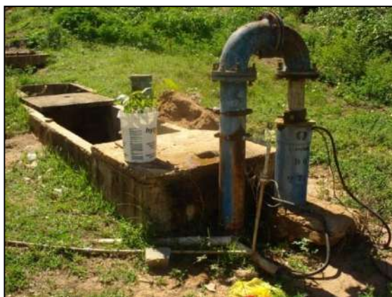
(a) Ponto de captação e das caixas de inspeção da tubulação de recalque
