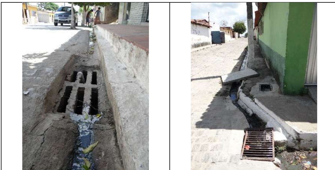
Figura 3. 2 – Águas servidas dispostas a céu aberto nos dispositivos de drenagem na sede do município de Baía Formosa. (conclusão)
