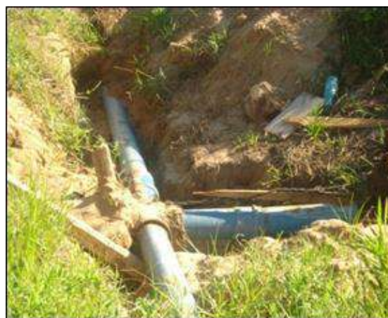
(b) Tubulação de desvio
