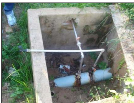
(d) Ponto de injeção da solução de desinfecção na linha de recalque e tubulação auxiliar para análise de cloro residual da água
