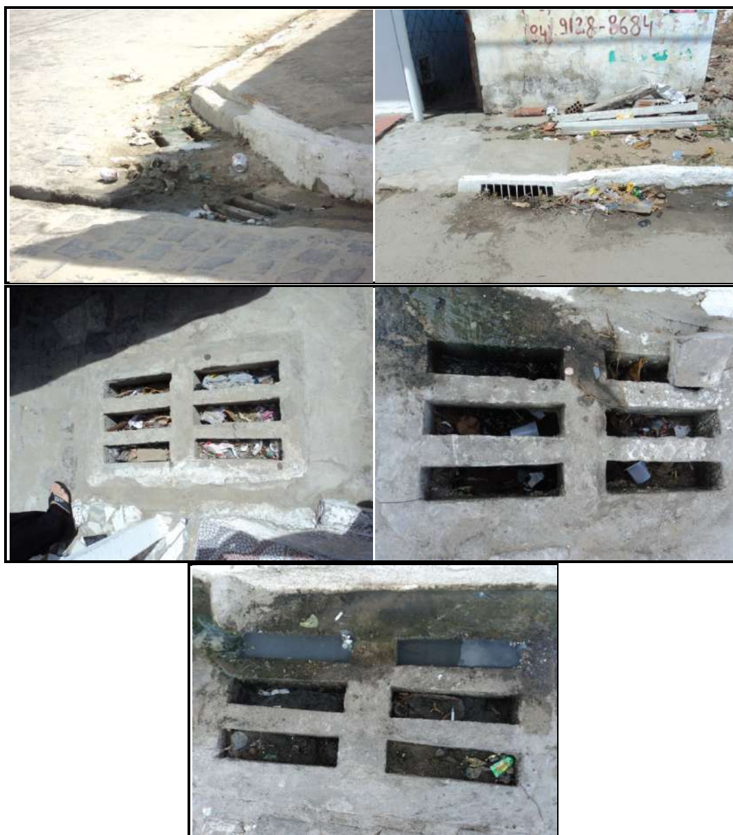
Figura 3. 10 – Obstrução de bocas de lobo devido à disposição inadequada de resíduos sólidos e o acúmulo de sedimento.
