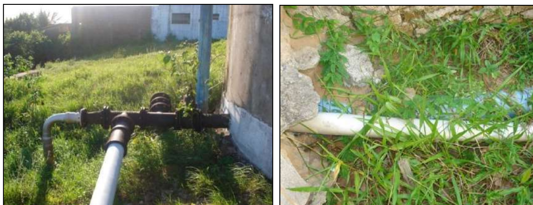
(a) Conexão das ligações na entrada do reservatório
