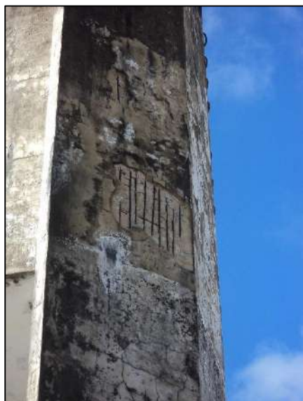
(b) Detalhe ferragem exposta
