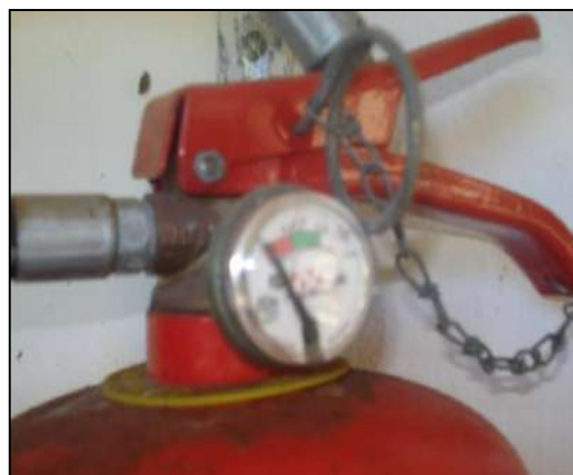
(b) Proteção contra incêndio
