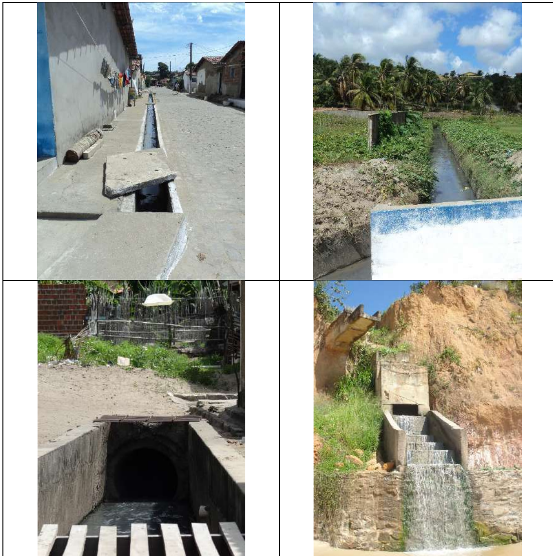
Figura 3. 4 – Águas pluviais e servidas na rede de drenagem da sede até o ponto de lançamento na Orla do município de Baía Formosa.
