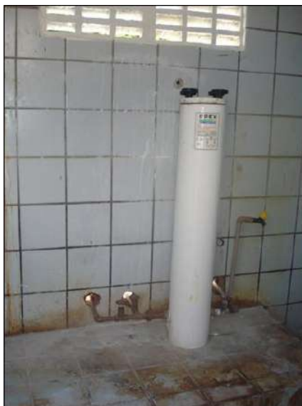
Figura 3. 14 – Dosador/dissolvedor de pastilhas de cloro do poço P2. Fonte: CAERN (2010).
