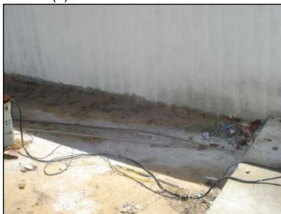
(d) Instalações elétricas e hidráulicas expostas
