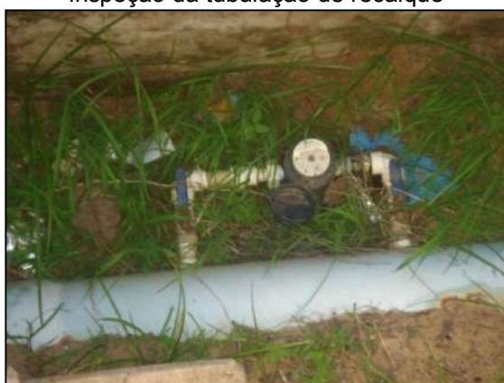
(c) Equipamento de controle de vazão instalado na tubulação de recalque
