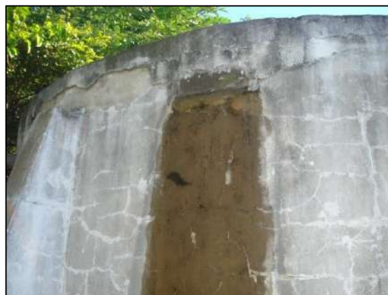
(d) Infiltração e fissuras
