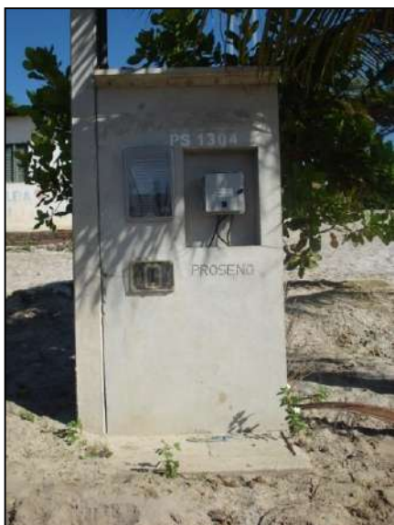
(a) Quadro de distribuição de energia elétrica
