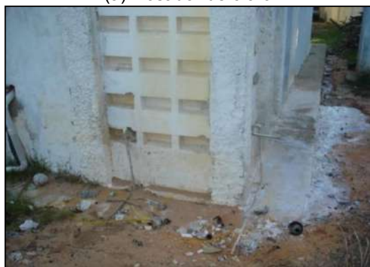
(c) Tubulação de entrada e saída na sala de desinfecção
