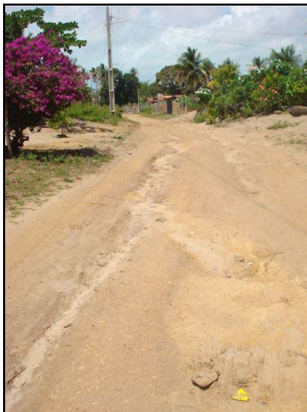
Figura 3. 13 – Erosão hídrica nas vias de acesso de Vila da Pituba.
