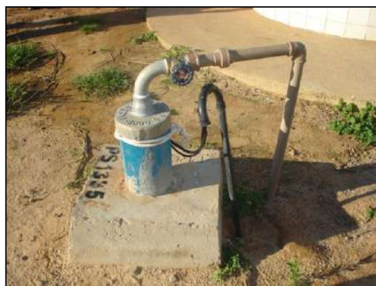
(b) Ponto de captação de água do poço
