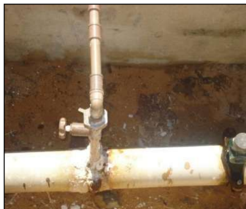
(d) Ponto onde se faz a injeção da solução desinfetante na tubulação que alimenta a rede de distribuição da cidade
