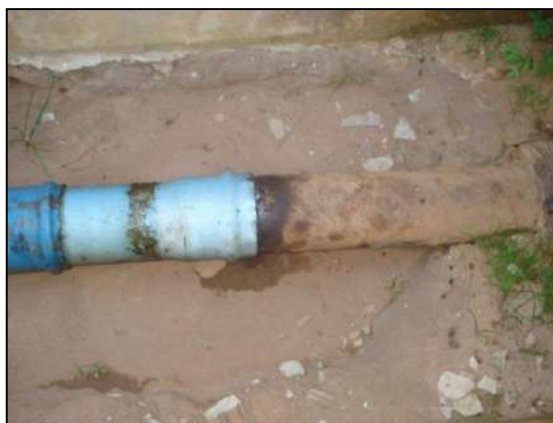
(b) Tubulação de recalque
