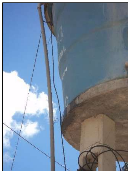
(d) Detalhe infiltração na laje
