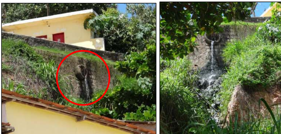
(b) Erosão hídrica na falésia próxima a praça dos pescadores
