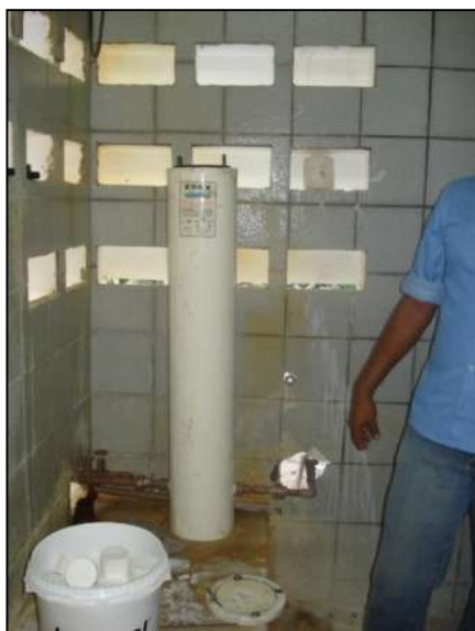
(a) Dosador de cloro
