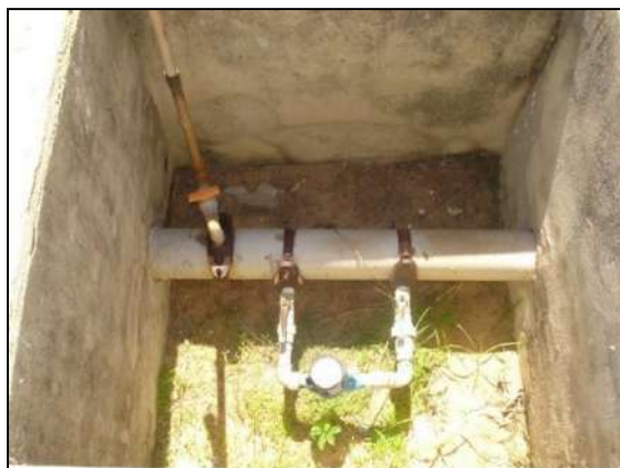
(c) Dispositivo medidor de vazão
