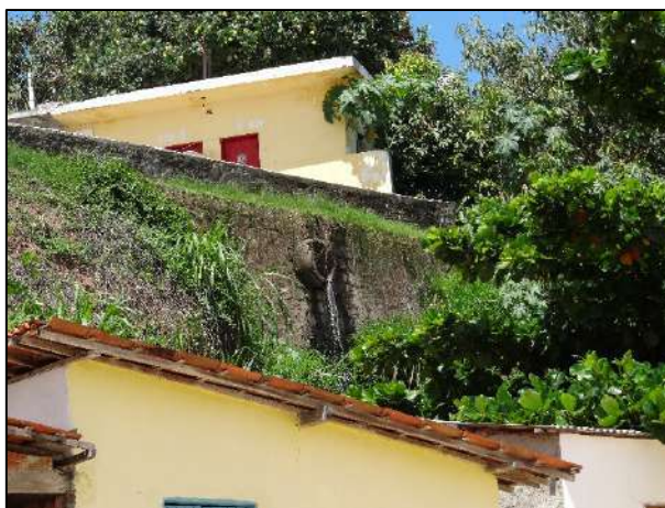
Figura 3. 3 – Ponto de lançamento de águas servidas nas proximidades da praia.
