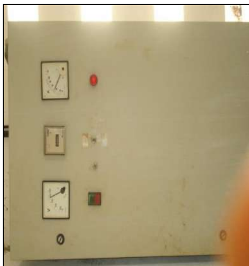
(a) Quadro de comando elétrico da bomba do poço P1A
