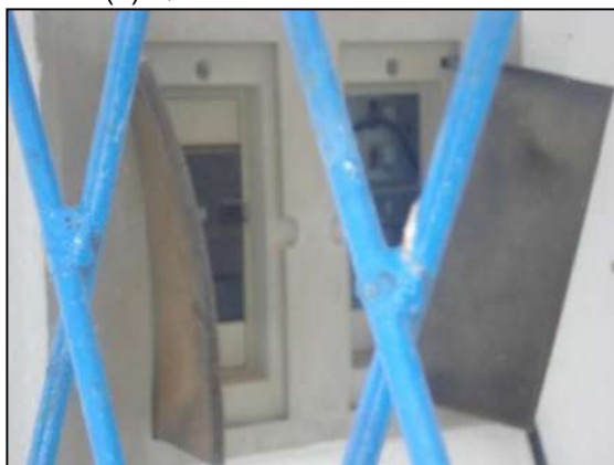
(c) Quadro de disjuntores
