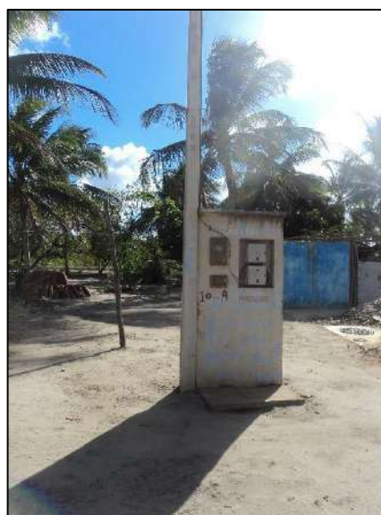
(b) Quadro de energia elétrica
