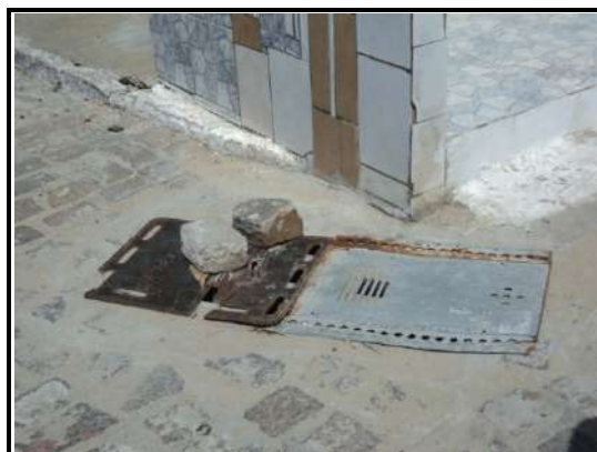
Figura 3. 11 – Obstrução de boca de lobo pela população.
