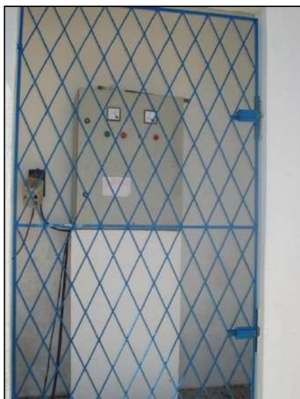
(a) Quadro de comando elétrico
